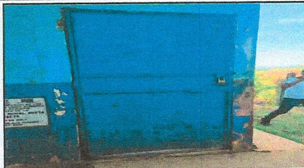
Remozamiento de puertas por oxidacion
